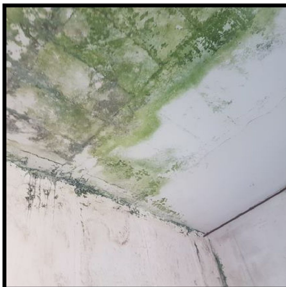
Foto 21 Interni alloggio padronale - Particolare degrado.JPG
